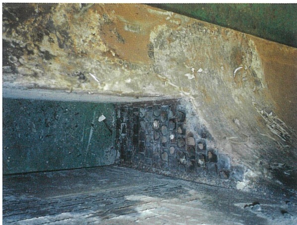
他社施工による脱落・摩耗
