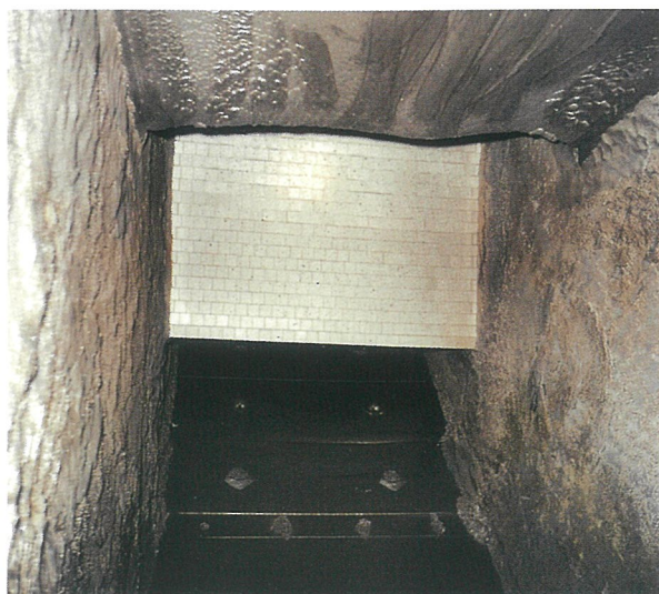
平成10年10月大穴損傷が発生し補修。2年経過磨耗なし
