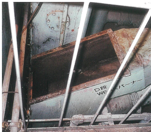
定検時に開放点検: 摩耗対策が必要
